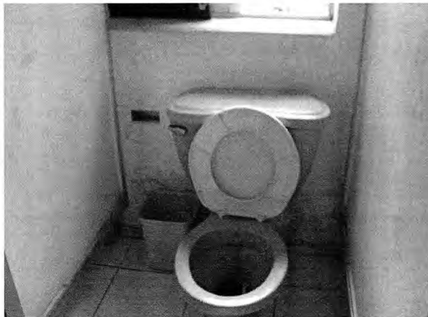
Foto N° 20: baño que se encuentra próximo a los dormitorios no cuenta con agua caliente
