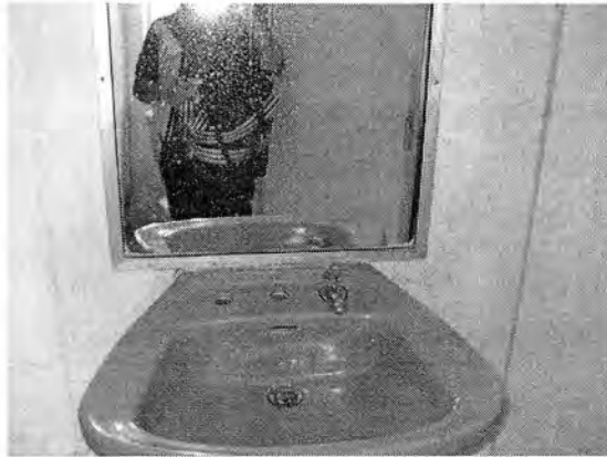
Foto N° 19: baño que se encuentra próximo a los dormitorios no cuenta con agua caliente
